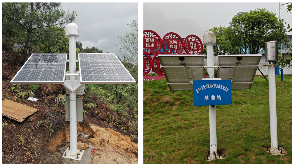
照片 5-59 北斗+安全综合监测预警系统
