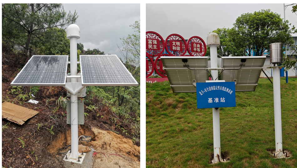
照片 5-41 北斗+安全综合监测预警系统
