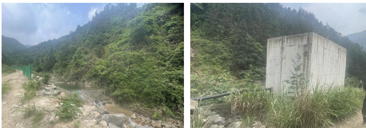
照片 5-22 牛路社区生活用水引水工程拦水坝、蓄水池
