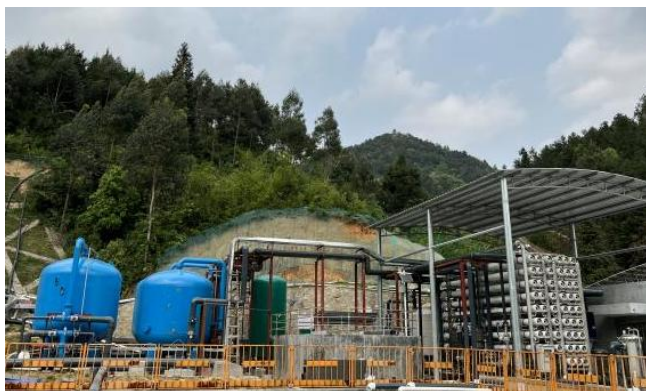
照片 5-15 高氨氮尾水处理设施
