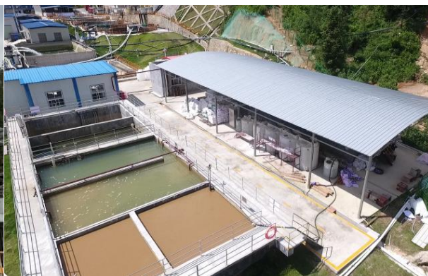
照片 5-16 低氨氮尾水处理设施
