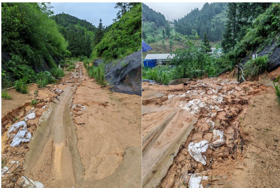
照片 7-1 截排水沟被雨水冲毁
